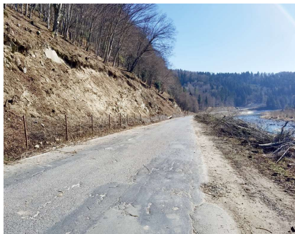
Obecny stan drogi na Leśnym - ul. Leśna FOT. ARCH. UMIGU MUSZYNA
