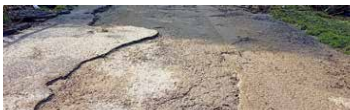
Droga w Wojkowej zniszczona przez nawałnicę FOT. ARCH. UMIGU MUSZYŃA
