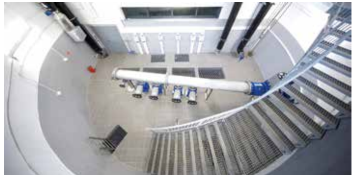
Przepompownia po modernizacji - Muszyna ul. Lipowa FOT. ARCH. PGK
