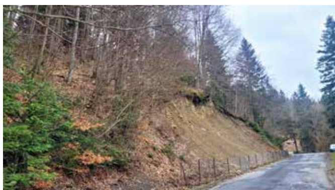
Osuwisko nad drogą przed stabilizacją ul. Leśna FOT. ARCH. UMIGU MUSZYNA
