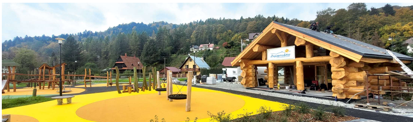
Część placu zabaw wraz z budowanym nowym lokalem gastronomicznym w Parku Rodzinnym nad potokiem Szczawnik FOT. ARCH. UMIGU MUSZYNA
